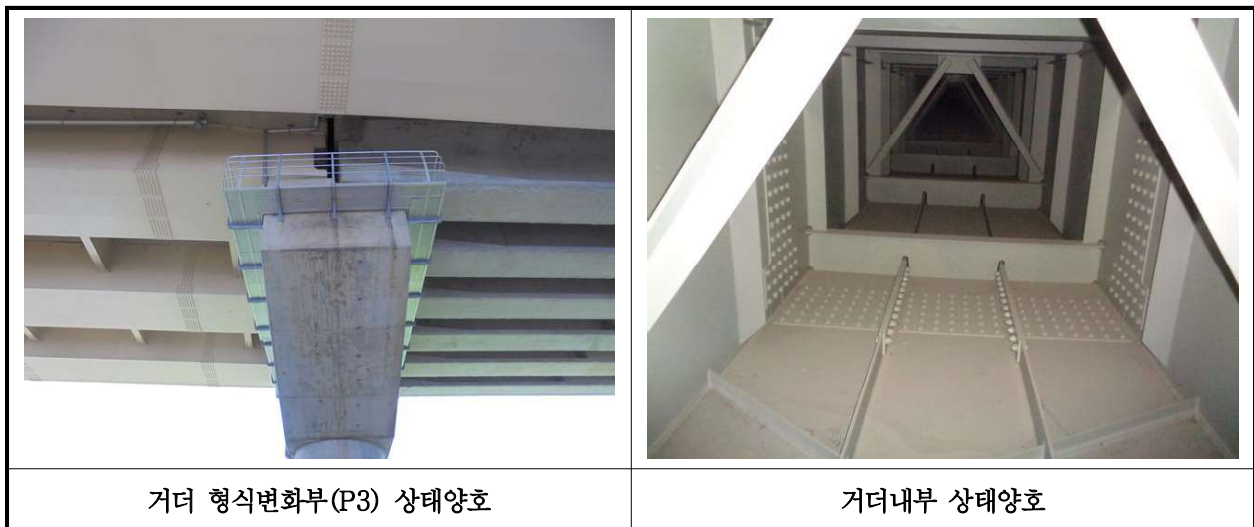
【사진 28.3.5】 거더 손상현황
